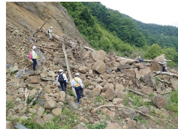
斜面崩壊箇所の踏査
