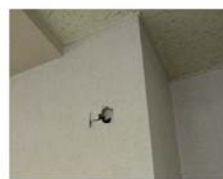
金具の抜けた後の壁
