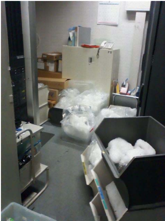
サーバ室冷却のため雪の塊を利用
